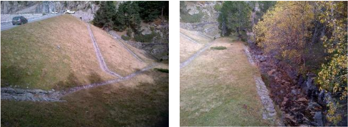
Figure 7 : Vue du parement aval du barrage en remblais (gauche) et de la descenderie de l'EVC en rive droite (droite)
